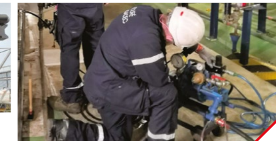
Arrêts de tranche : Interventions en arrêts de tranche sur les machines tournantes, pompes et turbines dans les Centrales de Nogent, Paluel, Dampierre et Penly.
